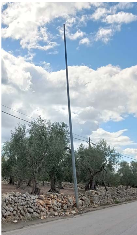
Un palo in attesa di manutenzione
